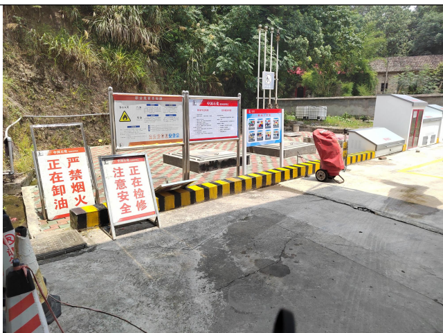
加油站油罐区
