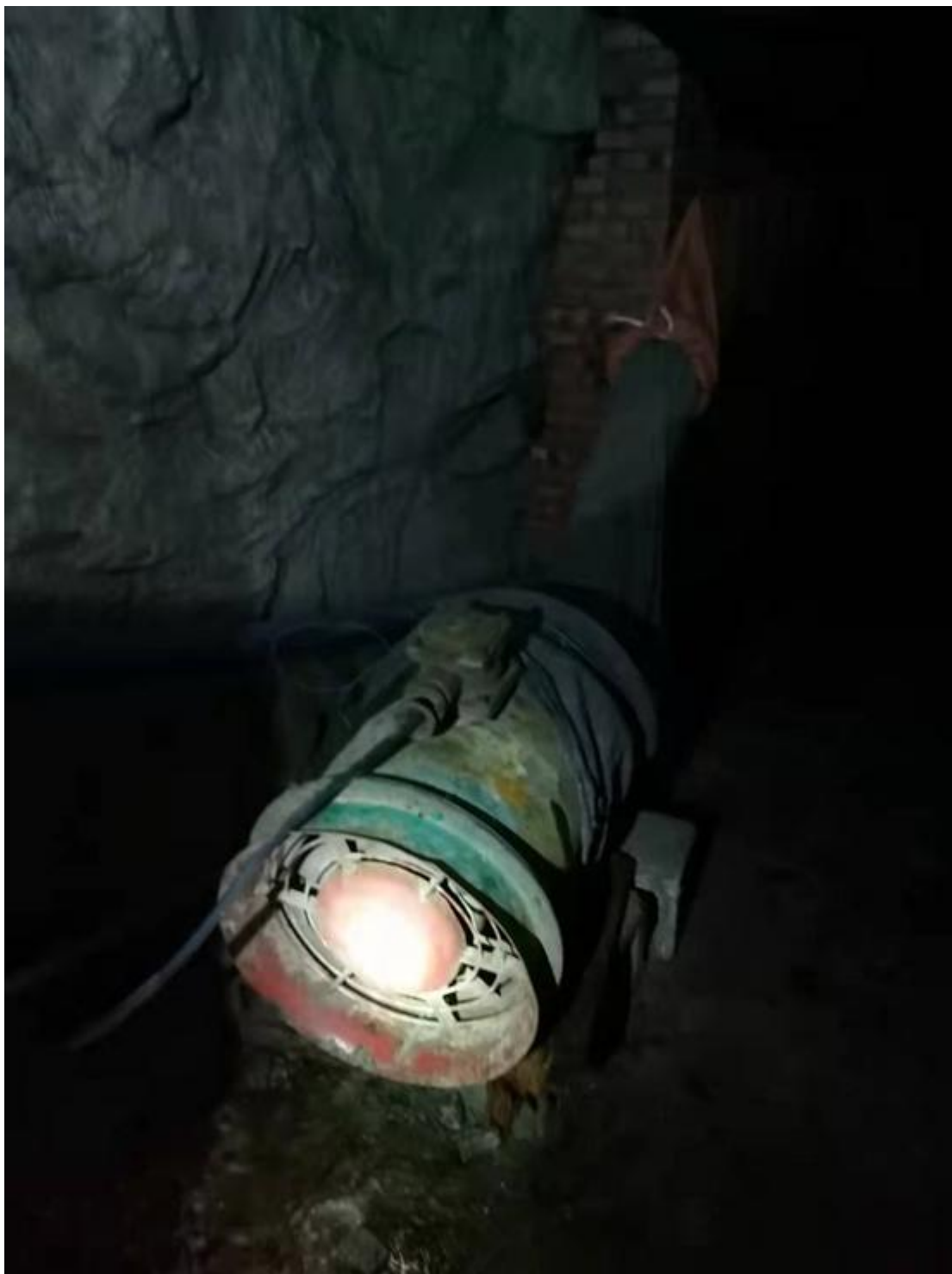
掘井工作面安装的局部通风机
